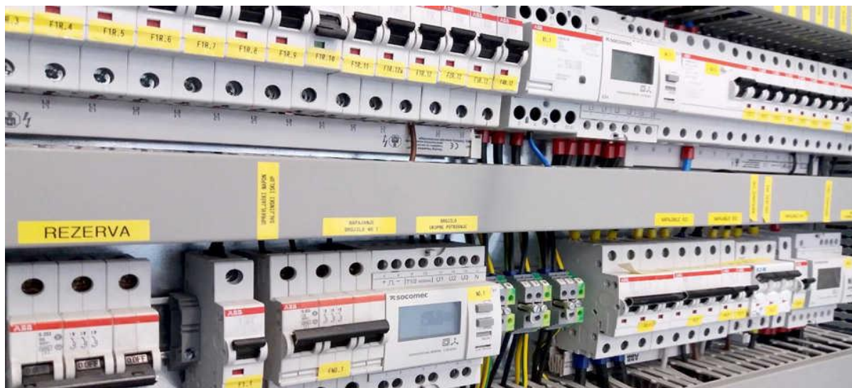
Slika 4.1-5 Označavanje uređaja unutar razvodnih ormara
