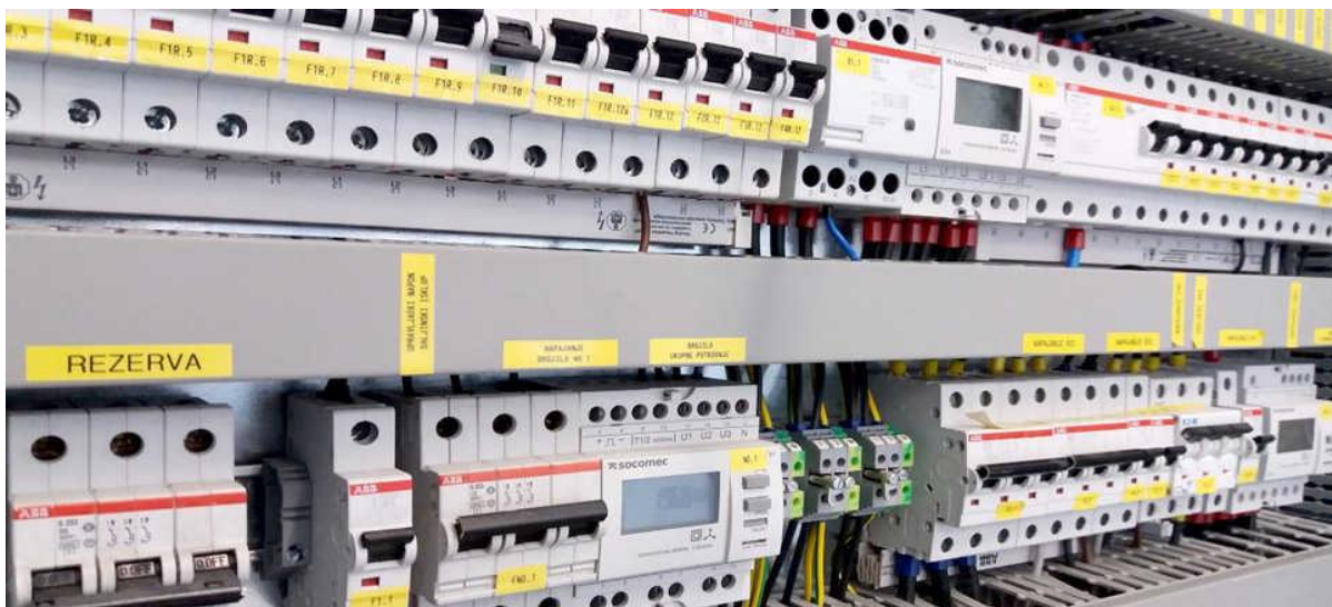
Slika 4.1-4 Označavanje uređaja unutar razvodnih ormara
